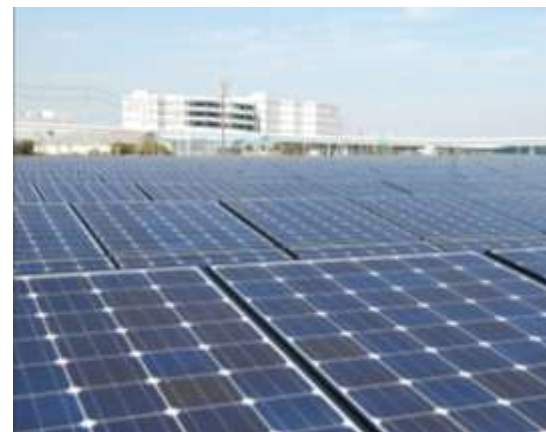
太陽光発電所
