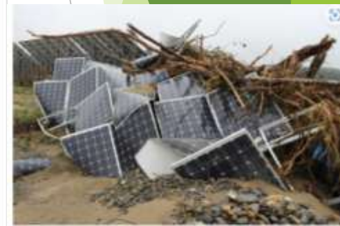
台風による被害で被災した太陽光パネルの例
