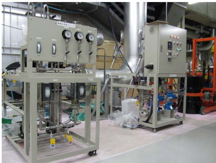
酸化チタン注入装置写真
