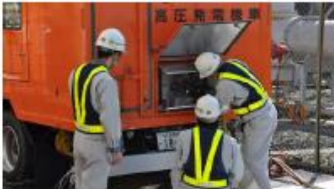
移動式発電機車を用いた電源つなぎ込み訓練
