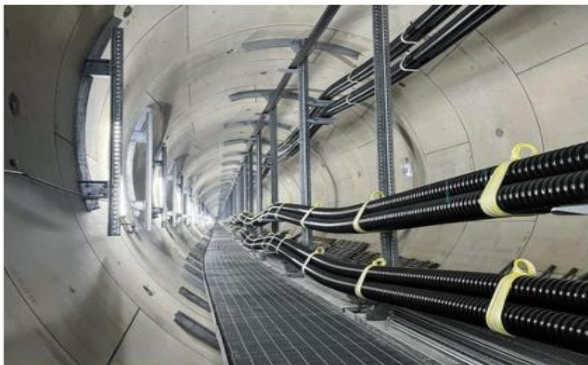
超高圧ケーブルが通る地下トンネル
