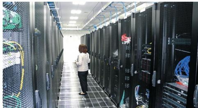
データセンター内部
