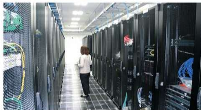
データセンター内部
