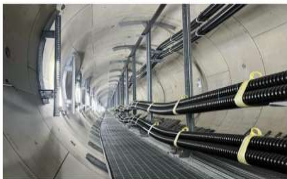
超高圧ケーブルが通る地下トンネル
