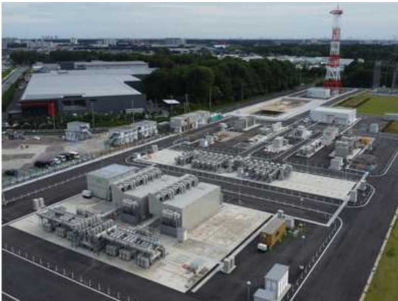
超高圧デジタル変電所
