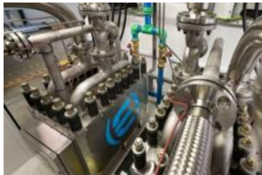
水素製造装置
