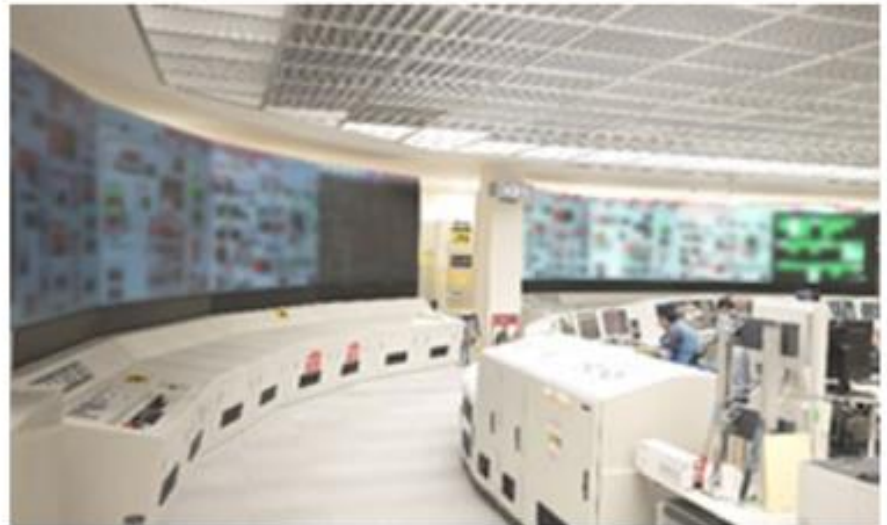
最新設計の中央制御盤のデジタル式への取替え(イメージ)
