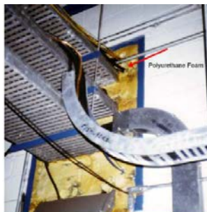
BF 1の火災の一因となったケーブル・トレイ貫通部のシール材の例
