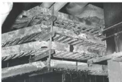
米国の火災防護規制強化のきっかけとなった Browns Ferry 1号機のケーブル火災(1975年3月22日発生)
