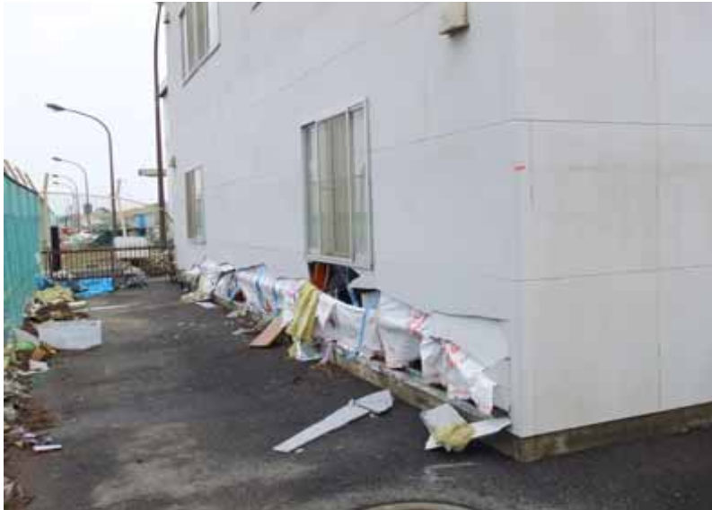
輸送本部建屋(S造)津波による外装材破損
