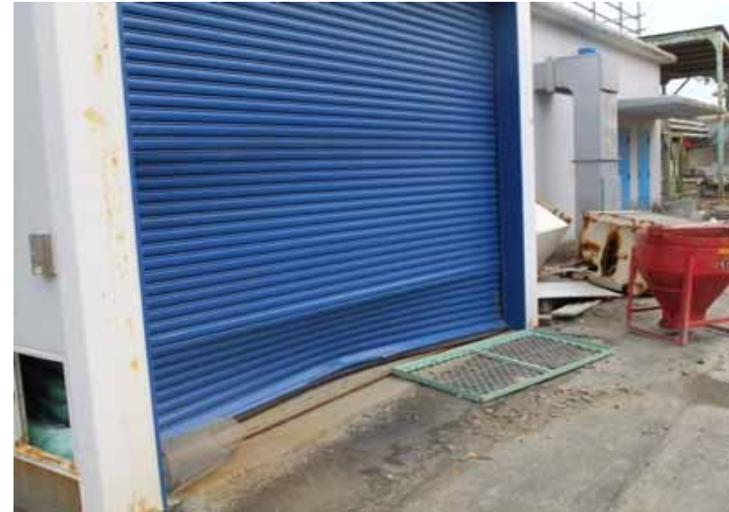
メンテナンスセンター(S造)シャッター変形
