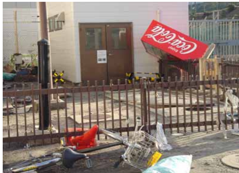
メンテナンスセンター(S造)自動販売機転倒
