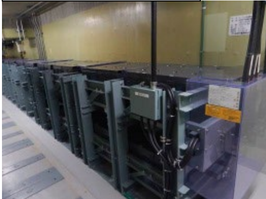
直流電源設備（蓄電池）
