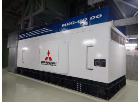
ガスタービン発電機 外観
