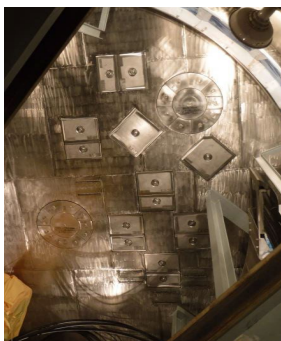
コリウムシールドの設置状況
