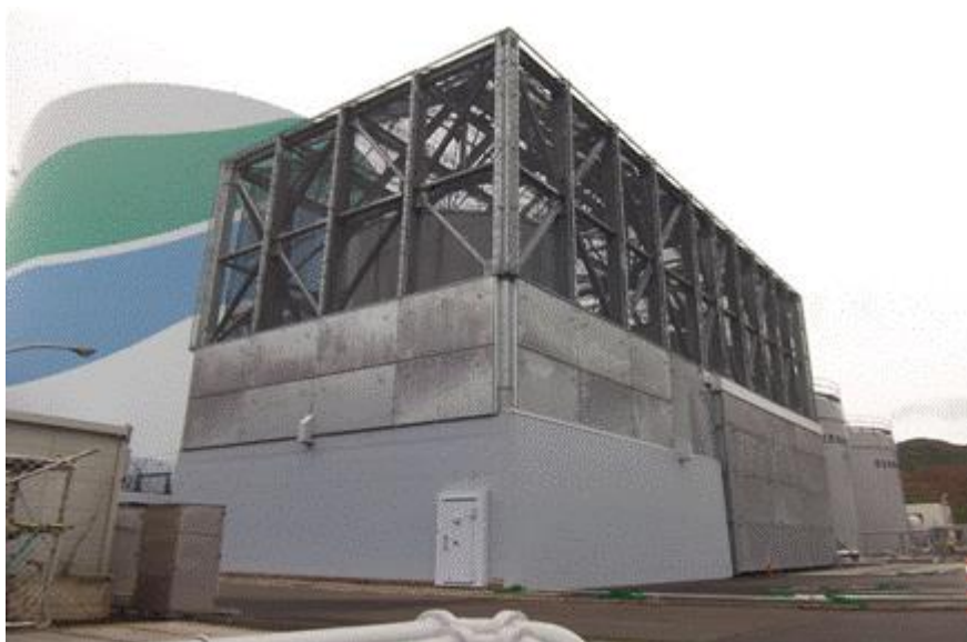
復水タンクの竜巻防護対策
