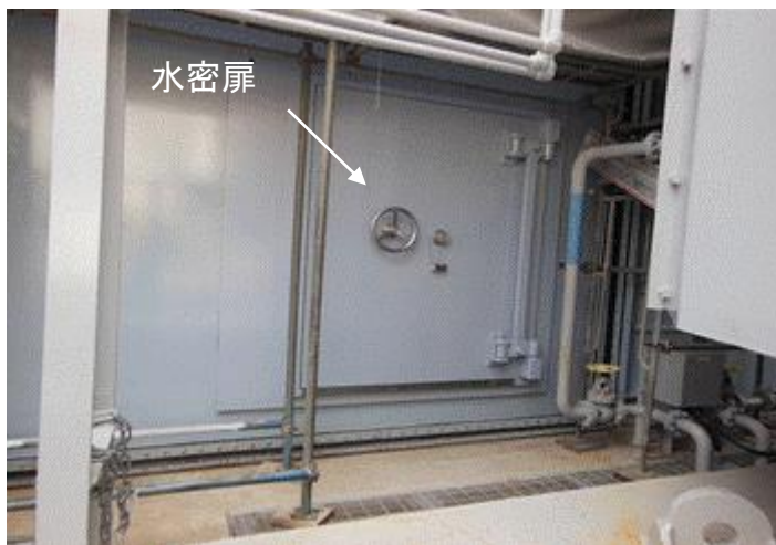
海水ポンプエリア内の水密扉
