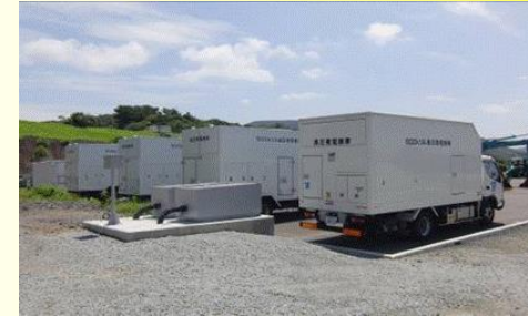
高圧発電機車(500kVA-6,600V)
