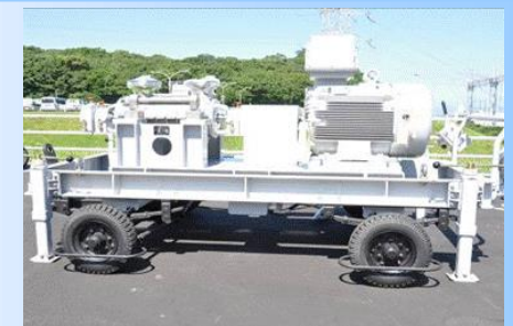
可搬型電動低圧注入ポンプ
