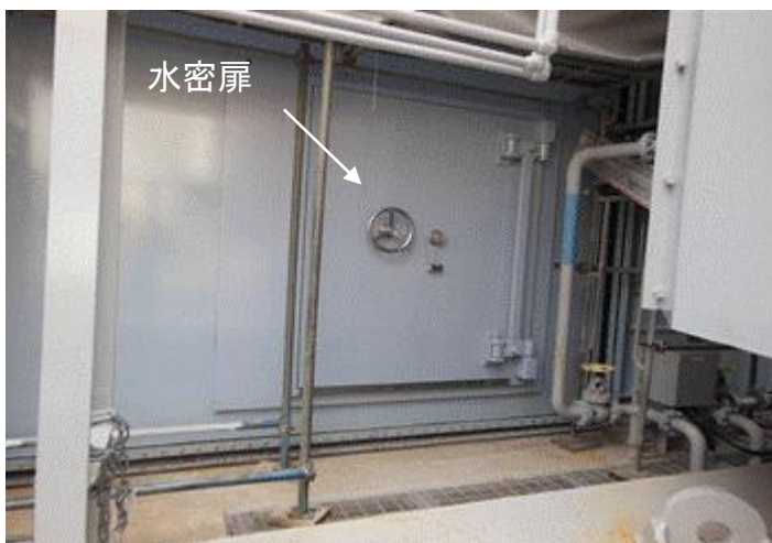
海水ポンプエリア内の水密扉
