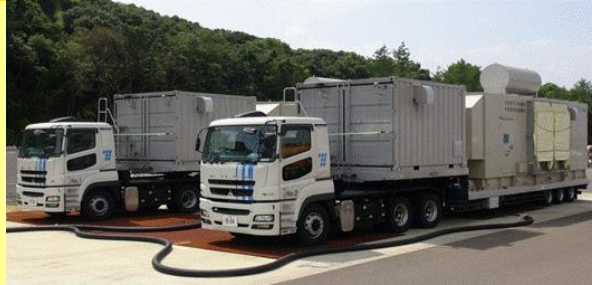
中容量発電機車(1,825kVA-6,600V)
