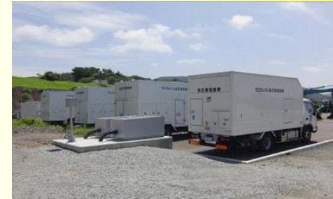
高圧発電機車(500kVA-6,600V)
