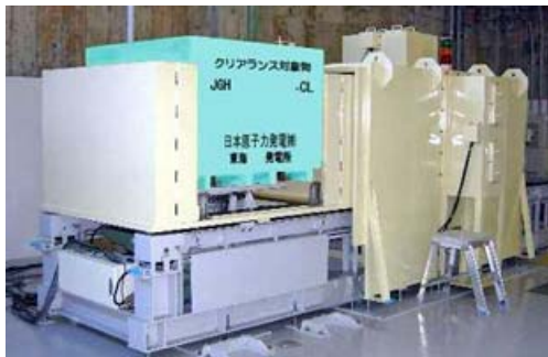
第2図 東海発電所で使用されたクリアランス制度対象物用の放射性核種濃度測定装置 1)
