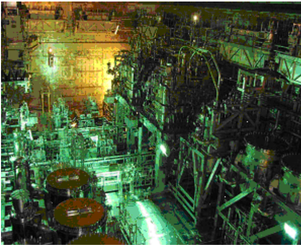
第7図 固化セルの外観 5)
