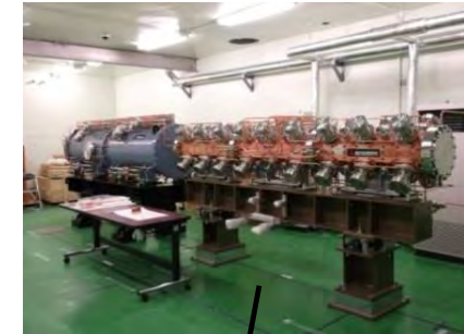
加速器室内に 設置した加速器
