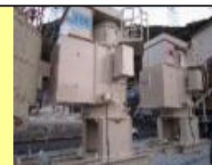
海水ポンプモータ予備
