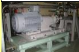
恒設代替低圧注水ポンプ
