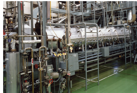
再転換ライン(焙焼・還元工程)
