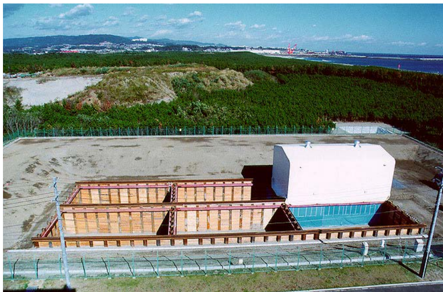
図 7 廃棄物埋設用トレンチ外観及び雨水浸入防止用テント（定置開始前）
