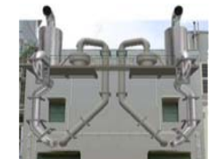
①吸排気口の嵩上げ(非常用ディーゼル発電機)
