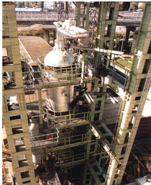
蒸気発生器気水分離器実圧試験
