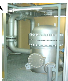
Heガス加熱器 高さ7.2m 直径1.0m
