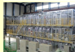
連続水素製造試験装置
