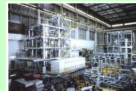
大型構造機器実証試験ループ (HENDEL)
